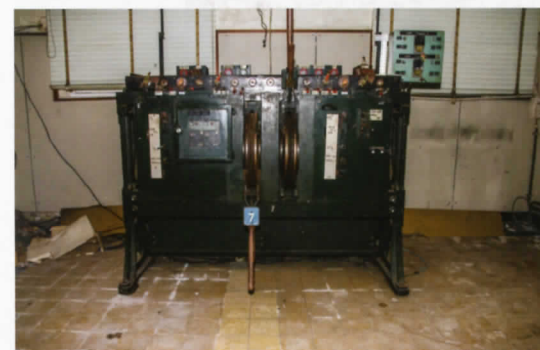
iii. 48 Het oude systeem van de sturing van de wissels en sporen dat vóór de afbraak van het station van Oostkamp nog aanwezig was in de lokettenzaal.
