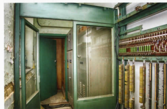
iii. 47 Het elektronisch relaisysteem was in het stationsgebouw van Oostkamp ondergebracht. Deze foto dateert van net vóór de afbraak van het gebouw.
